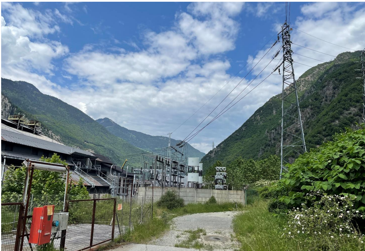
Figure 76 : Poste RTE présent sur le site du projet
